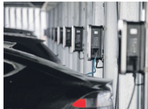
e361 realisiert komplexe Ladeinfrastrukturen – zum Beispiel für Unternehmensflotten.
