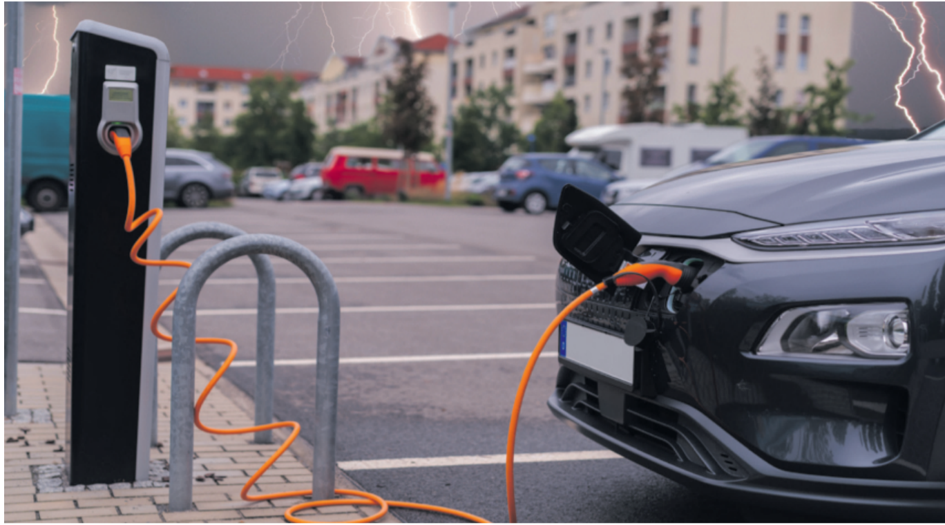
Wenn der Blitz einschlägt, können Ladeeinrichtung und angeschlossenes Fahrzeug stark beschädigt werden. Verhindert wird dies durch einen passenden Blitz- und Überspannungsschutz. Foto: Stock.Adobe.com/RonaldRampsch/swa182
