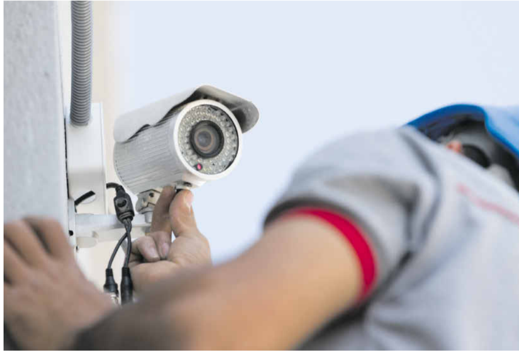
Sichtbar installierte Kameras haben oftmals eine abschreckende Wirkung, sodass es gar nicht erst zum Einbruchversuch kommt. Foto: ArGe Medien im ZVEH
