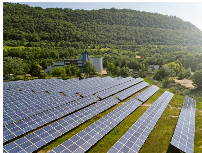
Die Photovoltaik-Freifläche bei Geislingen ist nur eine von vielen, die vom Albwerk installiert und betrieben werden. Fotos: Alb-Elektrizitätswerk Geislingen-Steige eG
