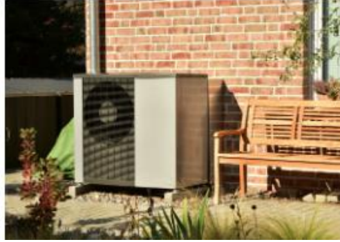
Wärmepumpen zur Raumheizung
