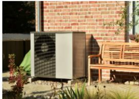
Wärmepumpen zur Raumheizung
